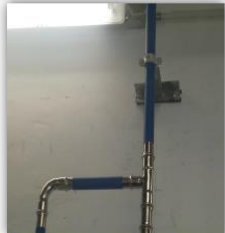
PE Forming pipes
